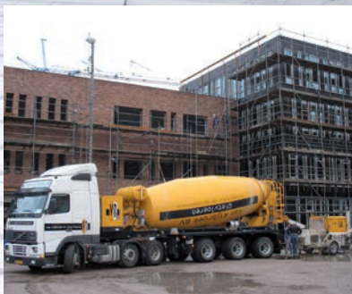
Aanvoer van kant en klare gietspecie vanaf onze centrale naar de bouwplaats.
